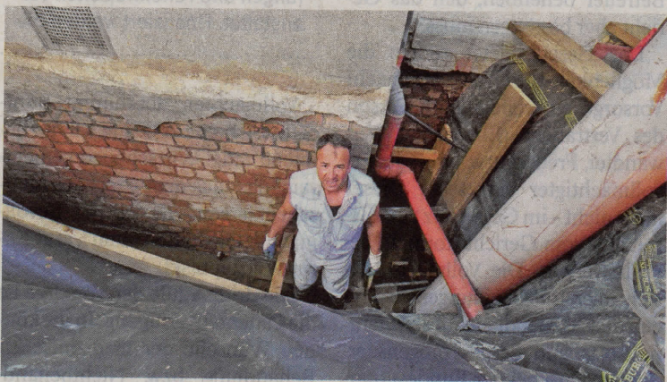
Adnan Aksoy aus Karnap hat Schäden an seinem Haus. Der Grund: steigendes Grundwasser. Anfang 2016 soll der Bau der Entwässerung beginnen. FOTO: KONOPKA
